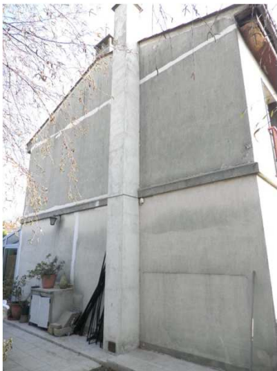
Toiture pas isolée Mur salon et cuisine au nord
